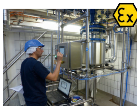
100 liter chemReactor with ATEX PLC control system 100 Liter chemReaktor mit ATEX SPS Steuerung
