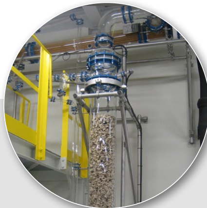
Solvent recovery, packed DN300 column, reflux condenser and controlled reflux divider Lösungsmittel-Rückgewinnung, Füllkörperkolonne DN300, Rückflusskondensator mit Rückflussteiler inkl. Regelung
