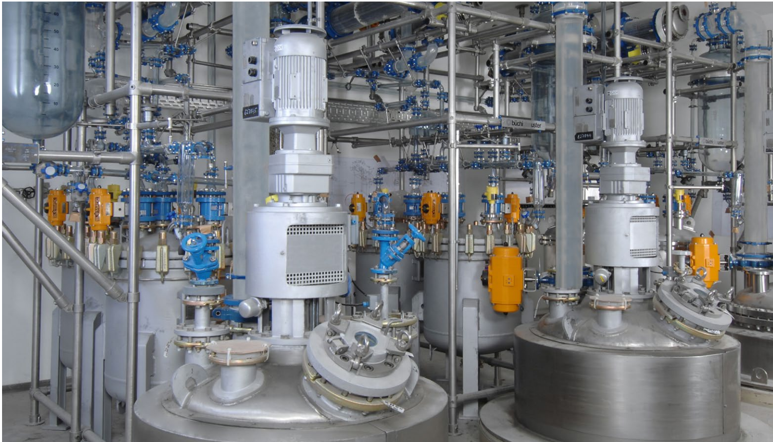
cGMP facility with 800 liter glass lined AE / BE reactors, distillation glass overhead with SiC condensers and glass lined receiver tanks for API production cGMP Anlage mit 800 Liter AE / BE Stahl-Emaillierten Reaktoren, Destillations-Glasaufbau mit SiC Kondensatoren und emaillierten Vorlagegefäßen für API Produktion
